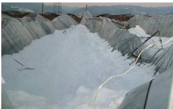
谷部の積雪による倒壊
