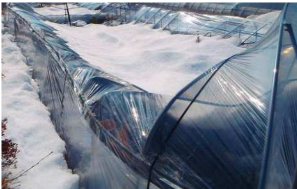
アーチ部の陥没
