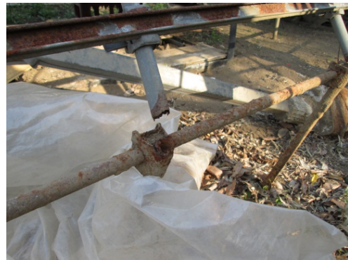
地際部の腐食による折れ
