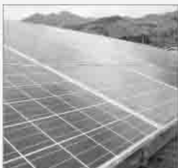
屋上に設置した太陽光パネル
