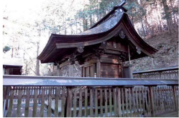
■経年劣化が進んでいる県指定文化財
