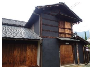
■旧高野家住宅 附・文庫蔵 外壁の黒漆喰の色が落ち、美観が損なわれているほか、土間のたたきが劣化し活用に支障が出ていた。（平成29年度）
