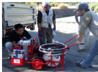
【新規消火設備 設置】 初期消火用の小型ポンプの導入
