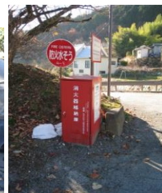
【既存の消火設備】
