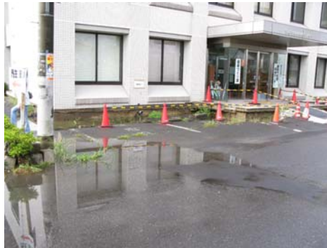
市役所隣の福祉センター。液状化で外構が沈下しています。
