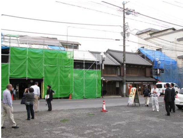
街道沿いの建物。青と緑のシートに挟まれた2棟は震災前に保存修理を行っており、被害はありませんでした。
