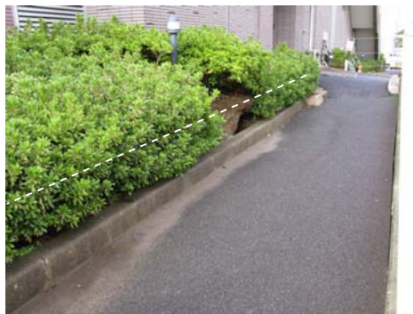
市役所の側壁面。アスファルト通路は、本来は白い点線の高さでした。
