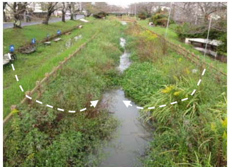
小さな河川。矢印のように川に引っ張られ沈下し、河床は逆に隆起しました。
