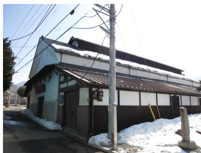
旧宮崎葡萄酒醸造所。屋根の雪の下に帯 状に瓦が壊れ、一部落下しました。
