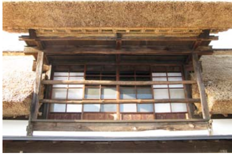
突き上げ屋根 突き上げ屋根の掃き出し部分は、古い材が残されていました。
