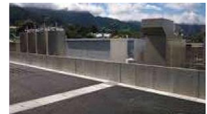
非常用自家発電機
