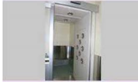
【エアシャワー室】
