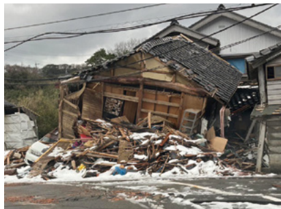
倒壊した家屋
