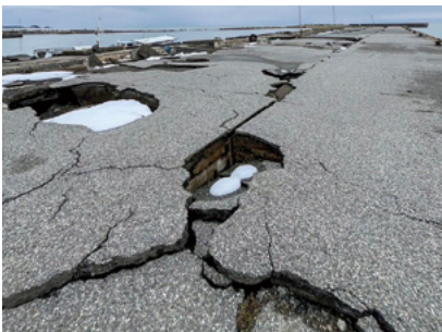
陥没した道路
