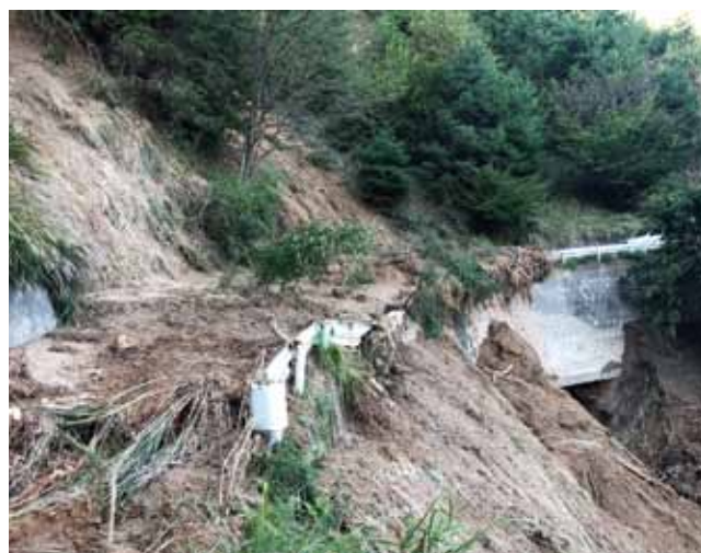
台風19号による林道上条平沢線の崩落現場
