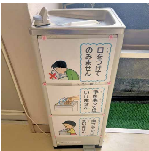
現在市内小学校に設置されている冷水機
