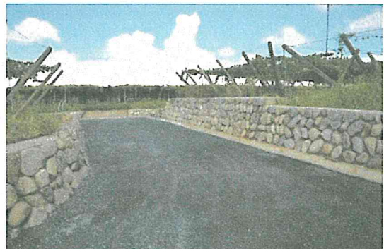
擁壁に丸石を使用しており、柔らかい景観になっている。
