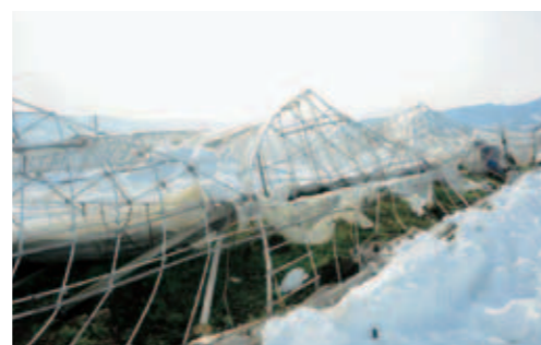
大雪による被害の様子(2014.2)
