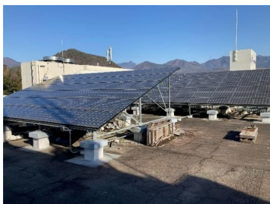
図3.6 甲州市役所本庁舎屋上の太陽光パネル
