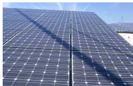
▲ 太陽光パネル
