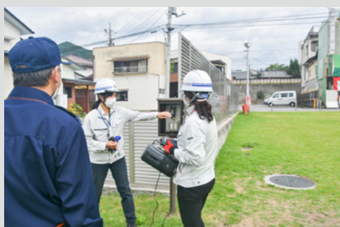
太陽光電源に切り替え、正常に作動するか確認
