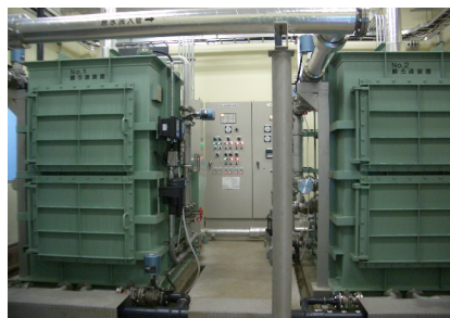
玉宮浄水場膜ろ過設備
