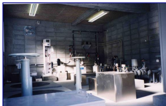
大和 中部配水ポンプ施設
