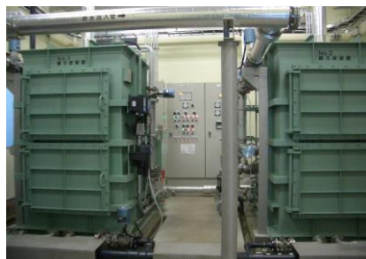
玉宮浄水場膜ろ過設備
