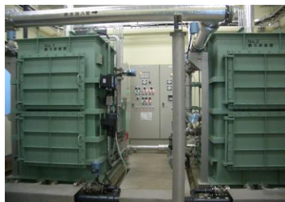
玉宮浄水場膜ろ過設備
