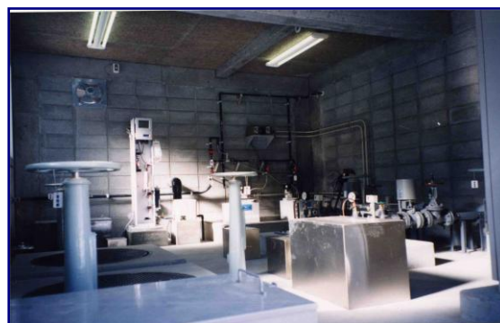
大和 中部配水ポンプ施設
