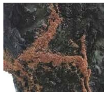
蟻道 (蟻が移動するトンネル)
