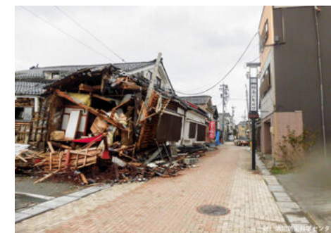
令和6年能登半島地震 出典：(一財)消防防災科学センター 「災害写真データベース」
