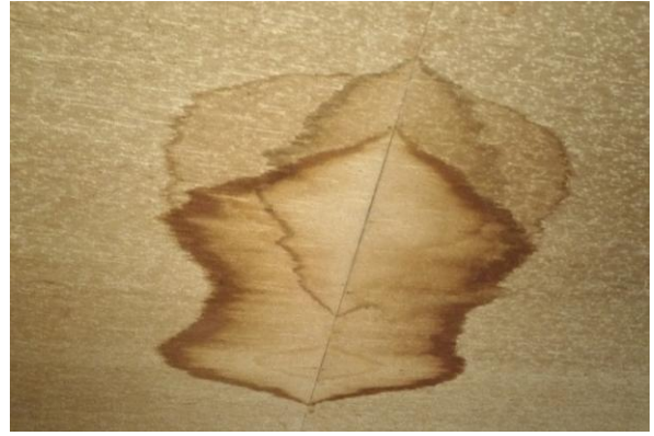
雨漏り跡(玄関ロビー天井)
