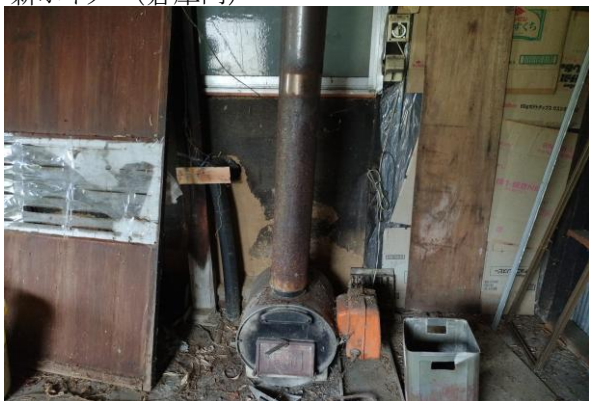
薪ボイラー(倉庫内)
